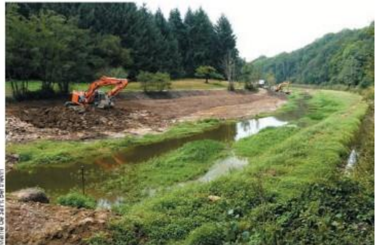
Mairie de Saint Berthevin Les travaux de terrassement du lit actif respectent le chenal préalablement retrouvé par la rivière
