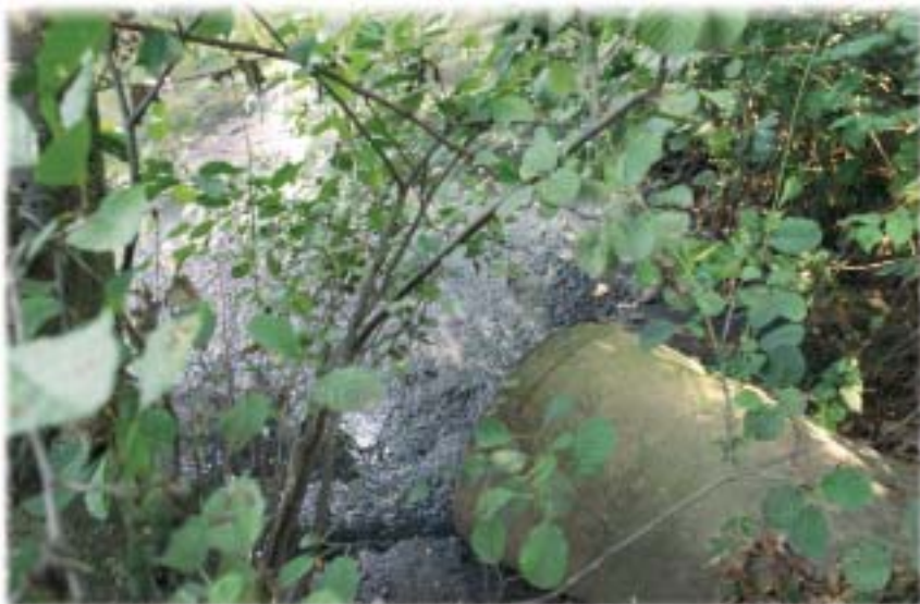
Rejet accidentel de station d'épuration en rivière Crédit photo : APSL
